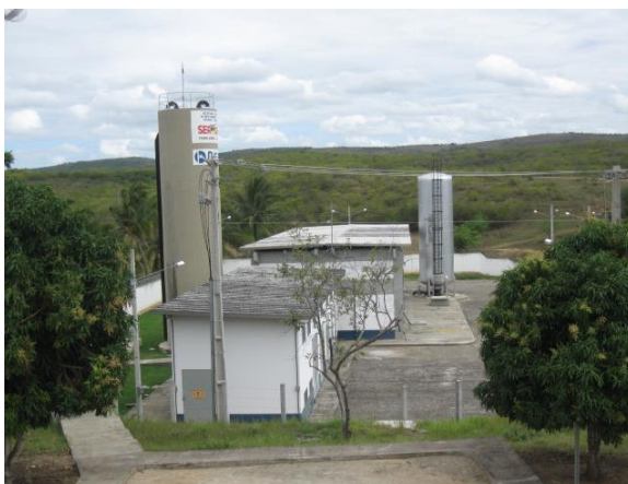
Estação elevatória de água bruta EE0A e subestação
