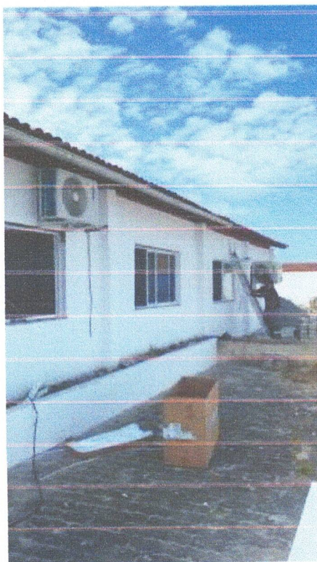
FOTO 3 – JANELAS DE ALUMÍNIO;
