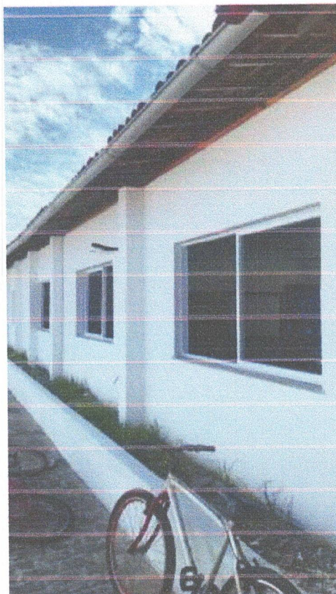
FOTO 2 – JANELAS DE ALUMÍNIO;
