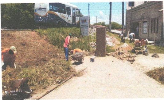
Entrada de energia
