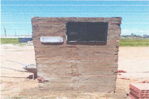
Entrada de energia elétrica - Praça Cj. Reinaldo Moura
